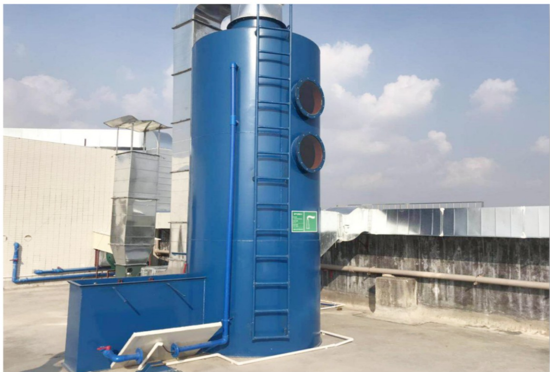
广州市水姻缘化妆品有限公司活性炭吸附装置废气治理
