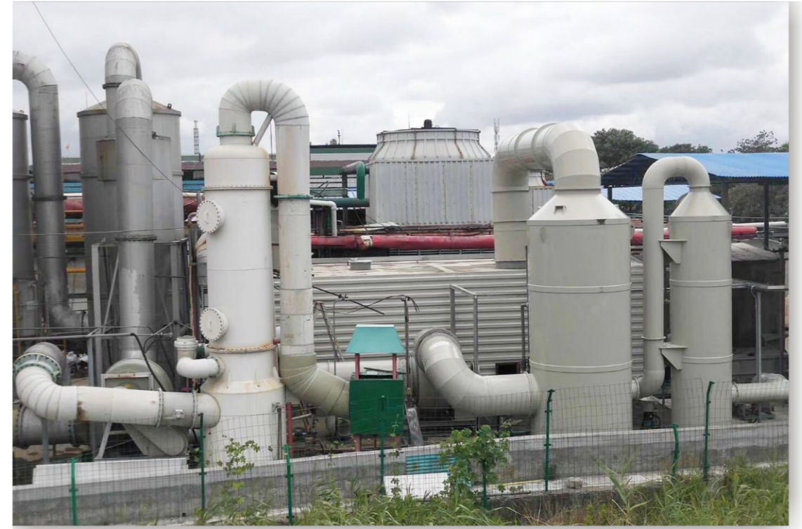
浙江药业股份有限公司废气治理
