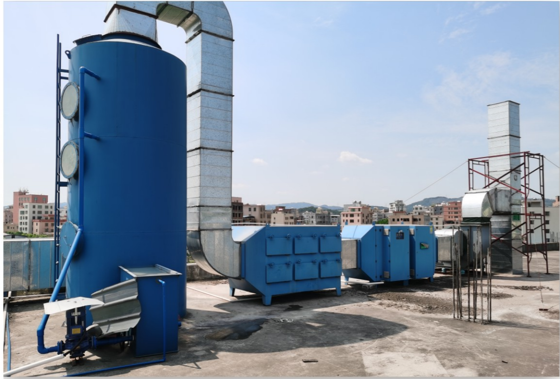
广州市铭润汽车贸易有限公司喷漆废气治理
