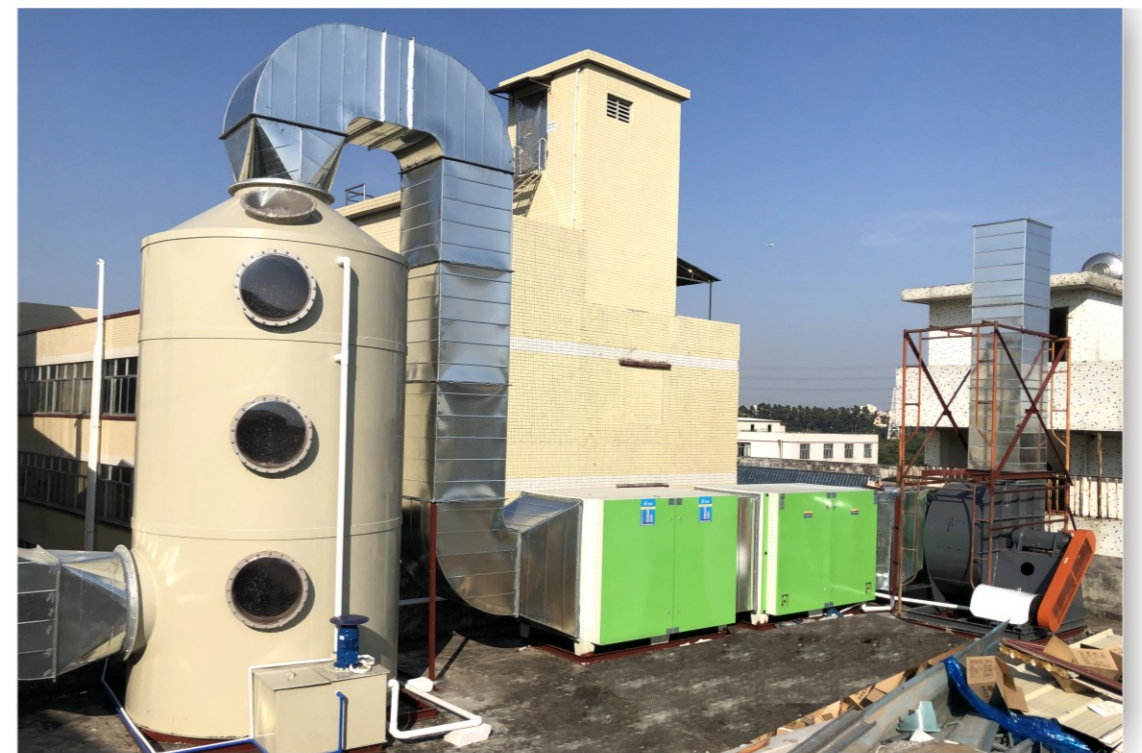
华星皮具（广州）有限公司废气治理工程
